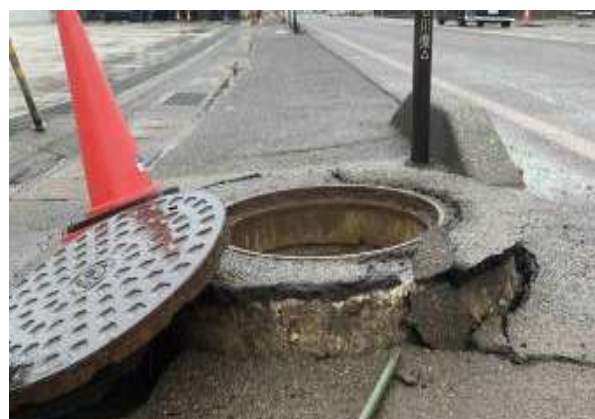
マンホール浮上
